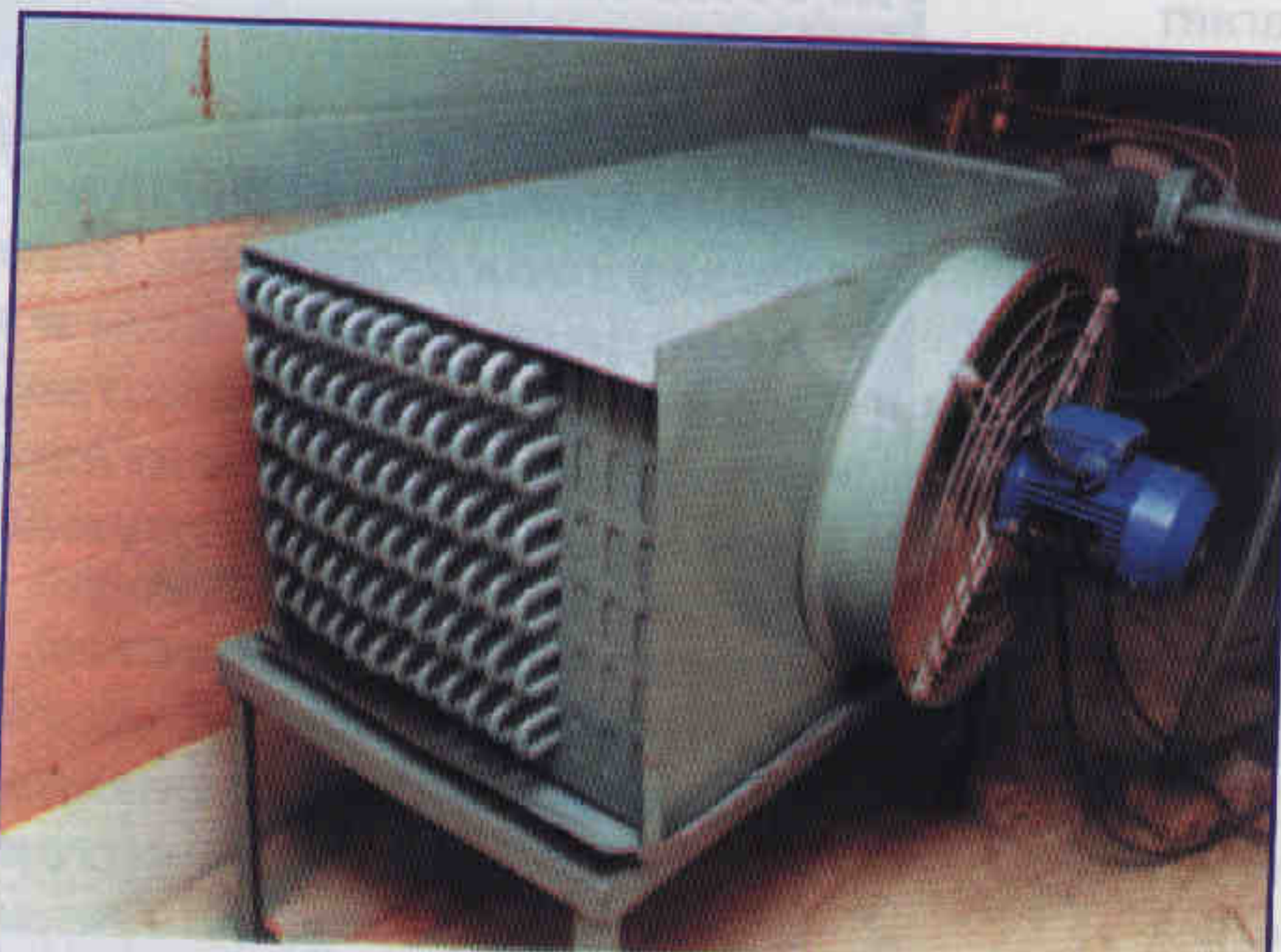
Рис. 2. Воздухоохладитель ВО-60 холодильной машины MBV25-2-0 на испытательном стенде
