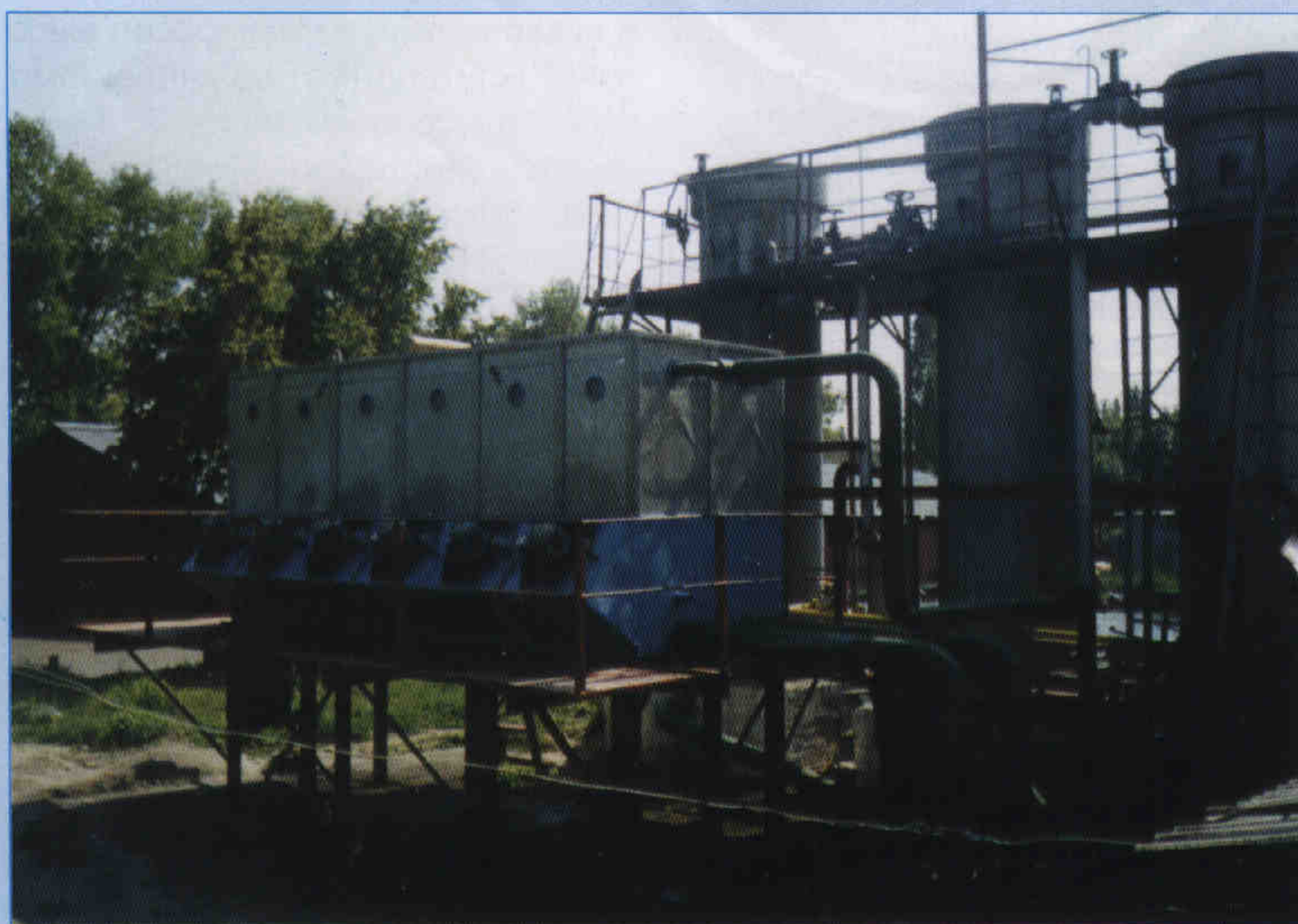
Конденсатор Я29-ИК-600 на ОАО «Хладокомбинат» (Воронеж)
