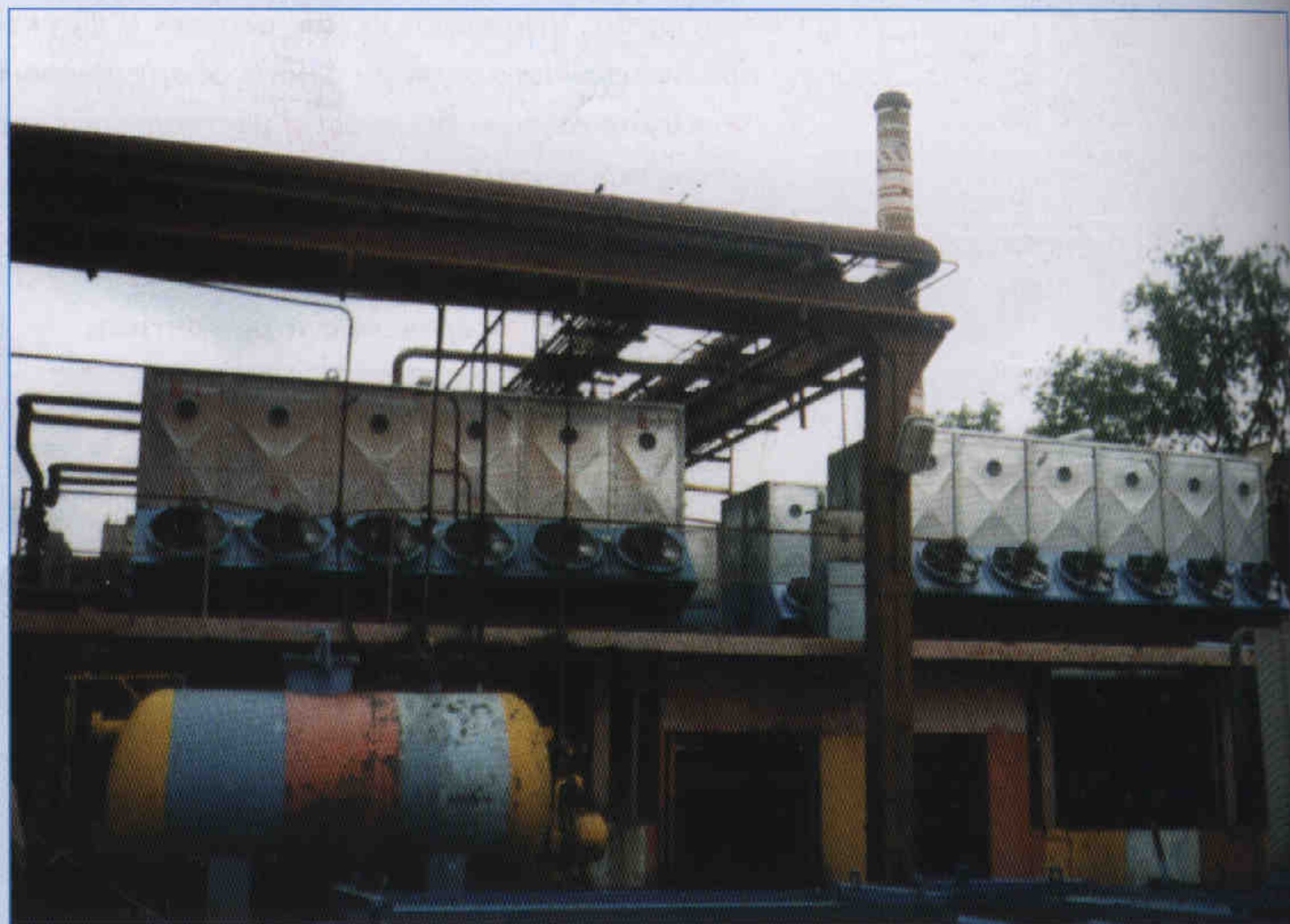
Конденсаторы Я29-ИК-600 на ОАО «Останкинский мясоперерабатывающий комбинат» (Москва)
