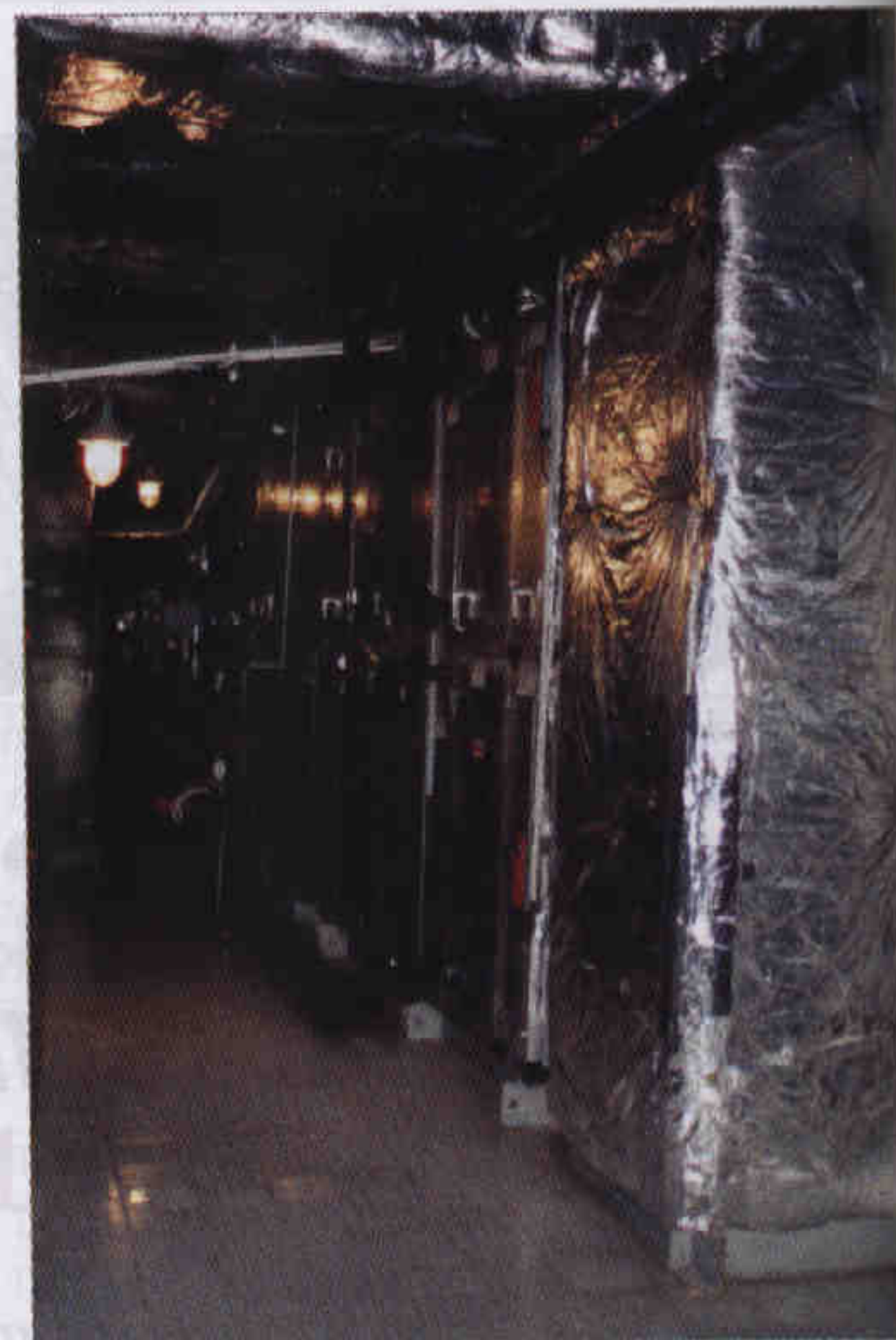
Рис. 4. Приточный агрегат КЦКП-25 со стороны обслуживания
