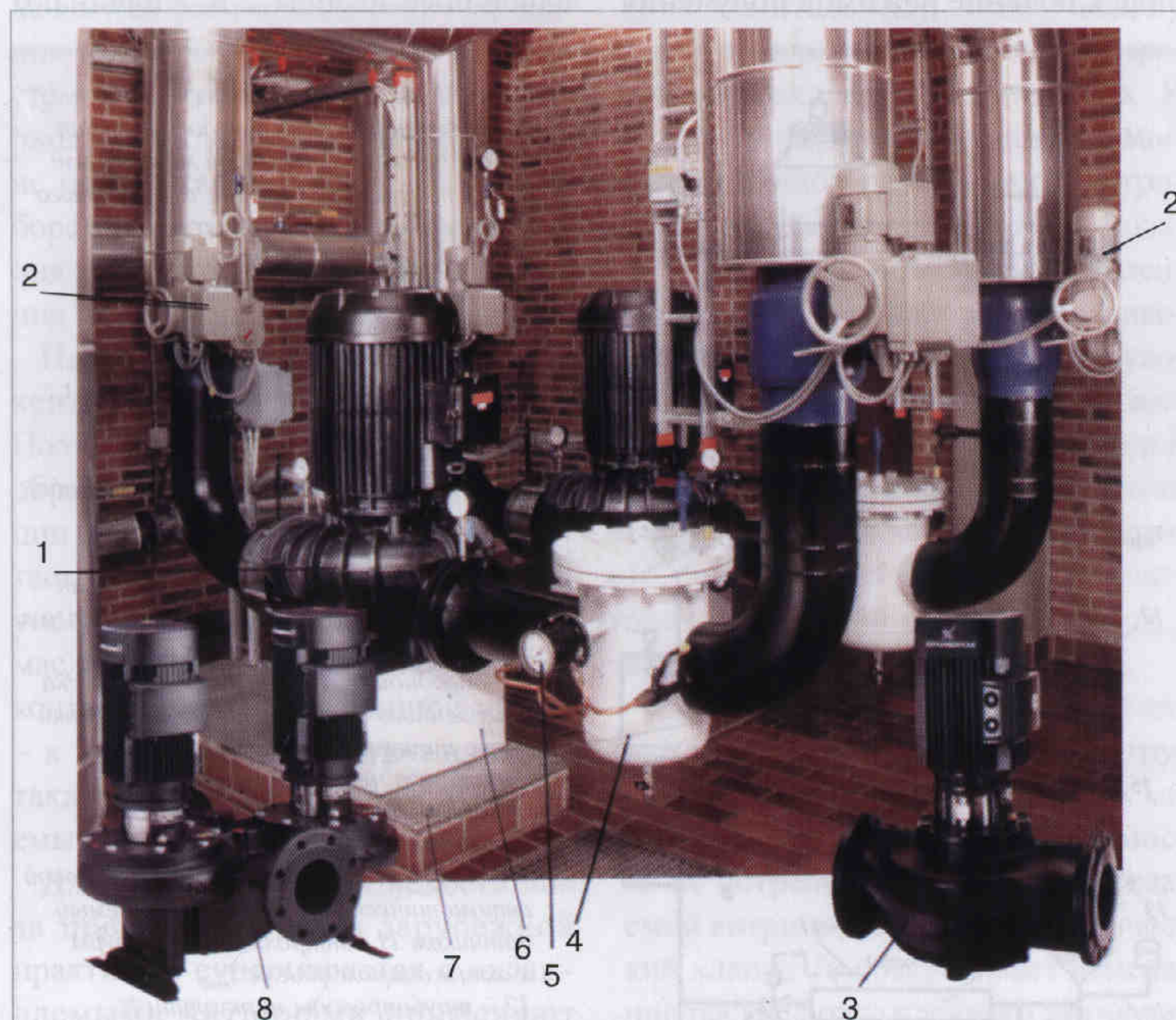
Рис. 2. Насосы фирмы «Грундфос», широко применяемые в системах холодоснабжения: 1 – одиночный насос CLM 200/315; 2 – запорные клапаны на всасывающих и нагнетательных трубопроводах; 3 – одиночный насос LP; 4 – водяной фильтр; 5 – прибор для измерения перепада давлений на водяном фильтре; 6 – бетонный цоколь фундамента с анкерными болтами для крепления корпуса насоса; 7 – пробковые плиты основания фундамента насоса; 8 – сдвоенный насос LPD.
