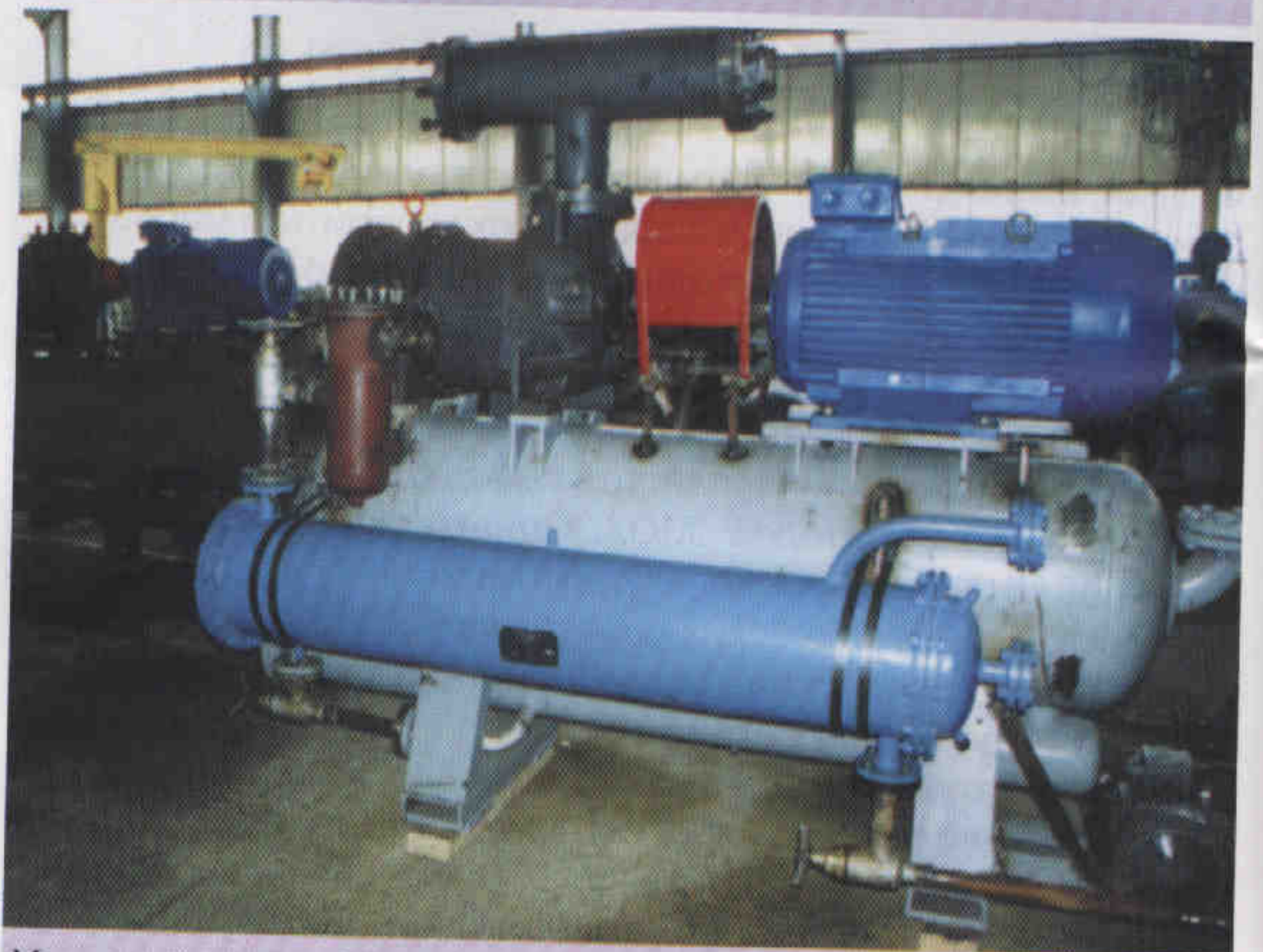
Монтаж на производственной базе «Нахабино» винтового компрессорного агрегата 21A410-7-3 с маслоохладителем МОХ 36-300-1,5
