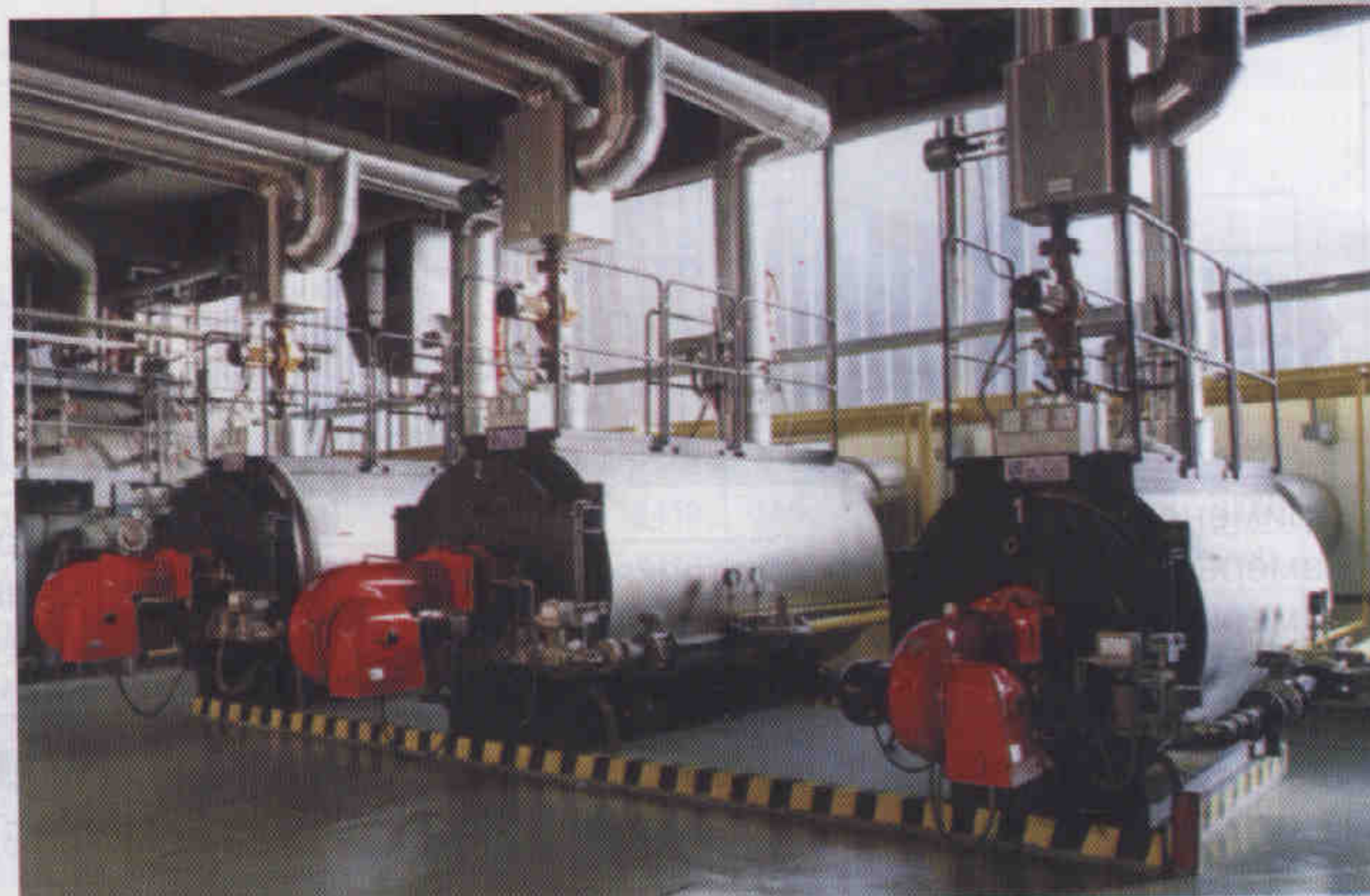
Газовая котельная мощностью 3600 кВт
