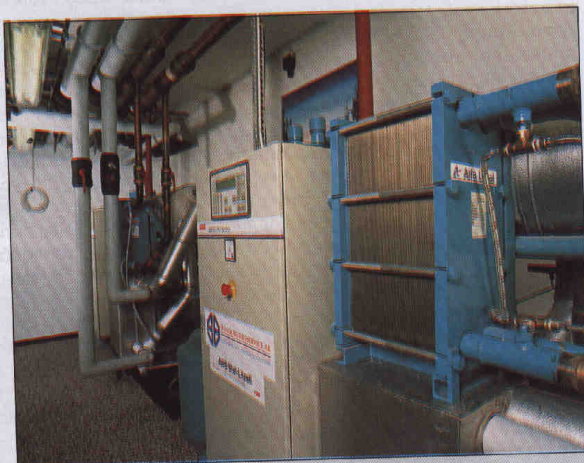
Рис. 2. Никельпаяные теплообменники «Альфа Лаваль» в установке холодоснабжения супермаркета. В качестве вторичного хладагителя для замораживания используется CO 2
