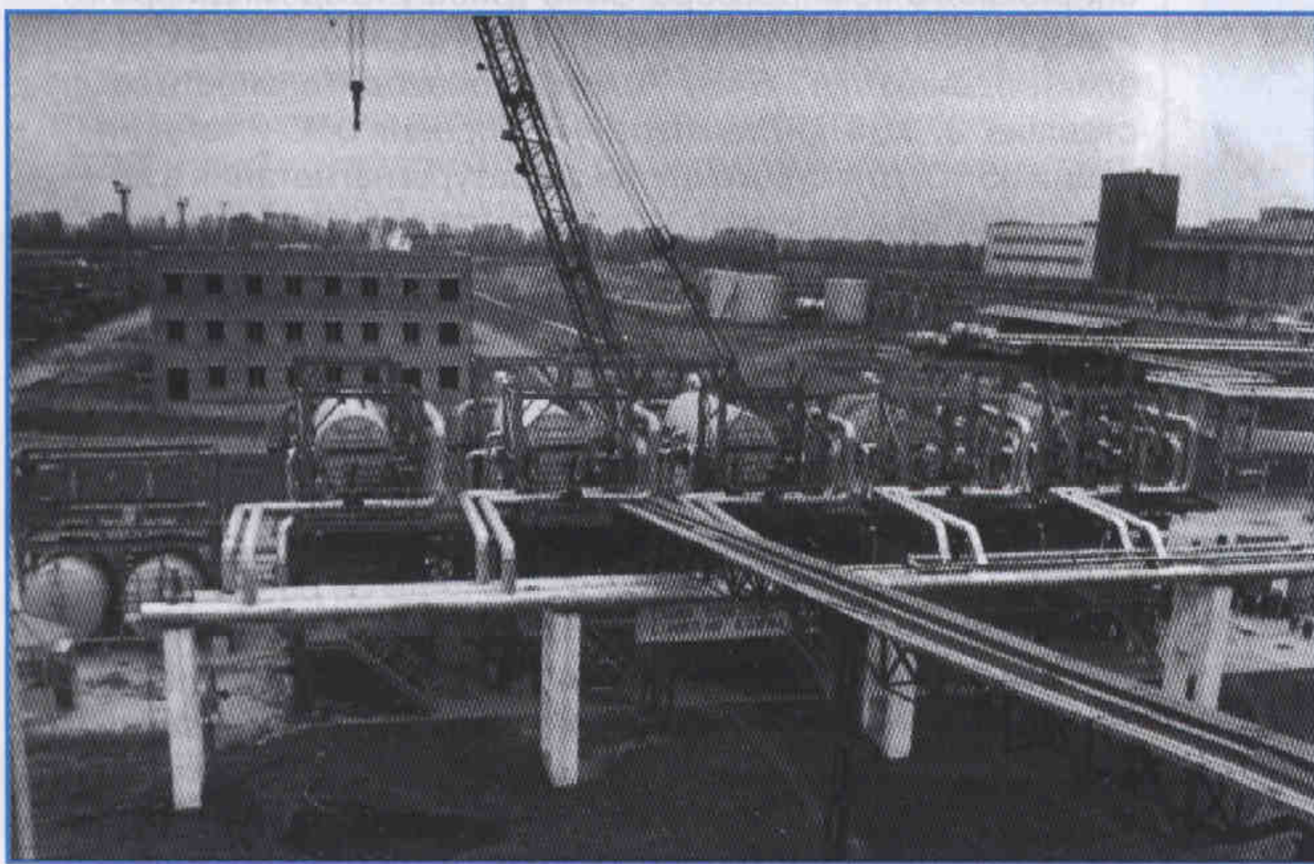
Рис. 1. Холодильная станция Белоцерковского завода шин и РАИ
