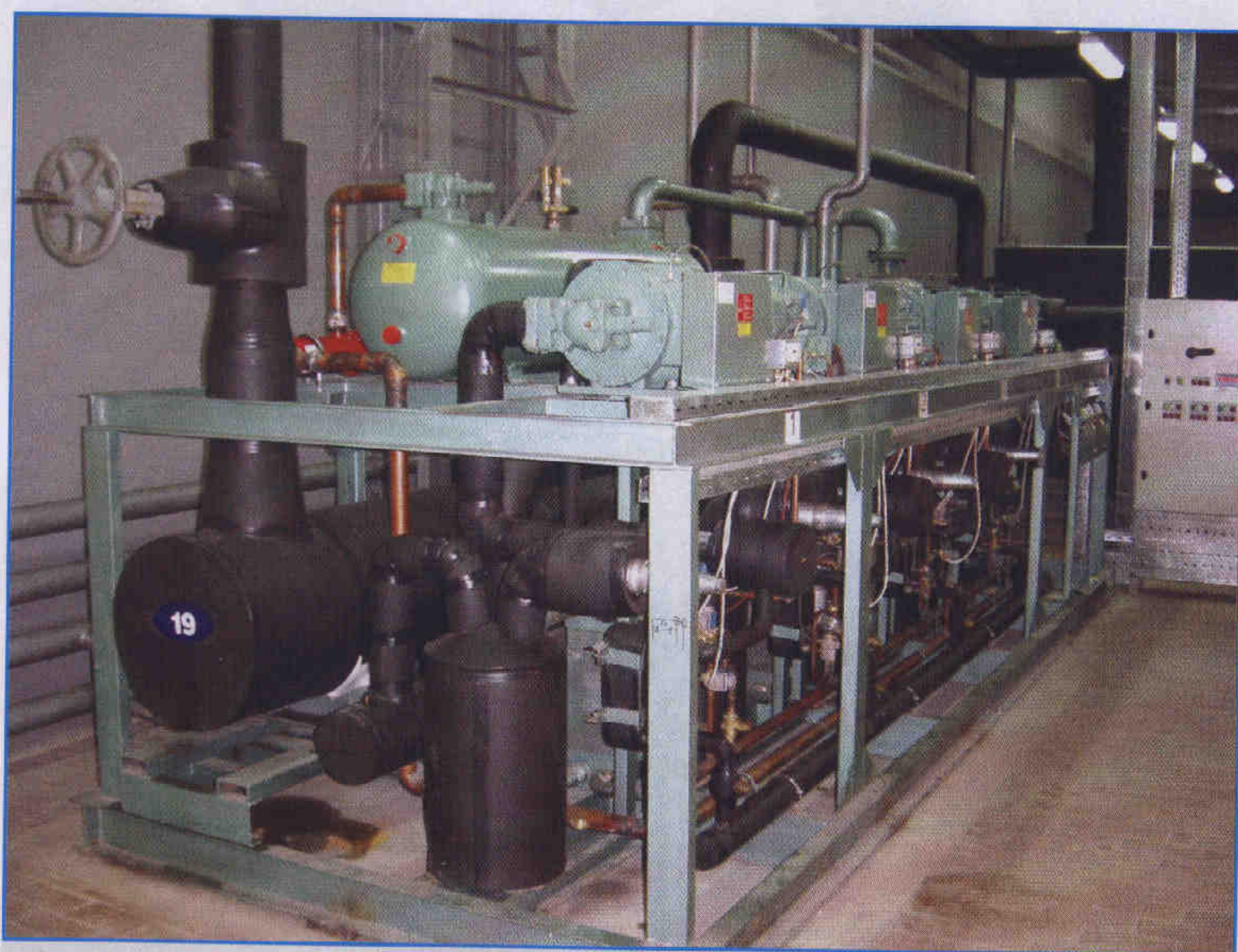
Рис. 1. Чиллер холодопроизводительностью 475 кВт ( t_0 = -19^\circ\text{C} , t_k = 44^\circ\text{C} ) на базе компрессоров HSN7471-75 (Bitzer)
