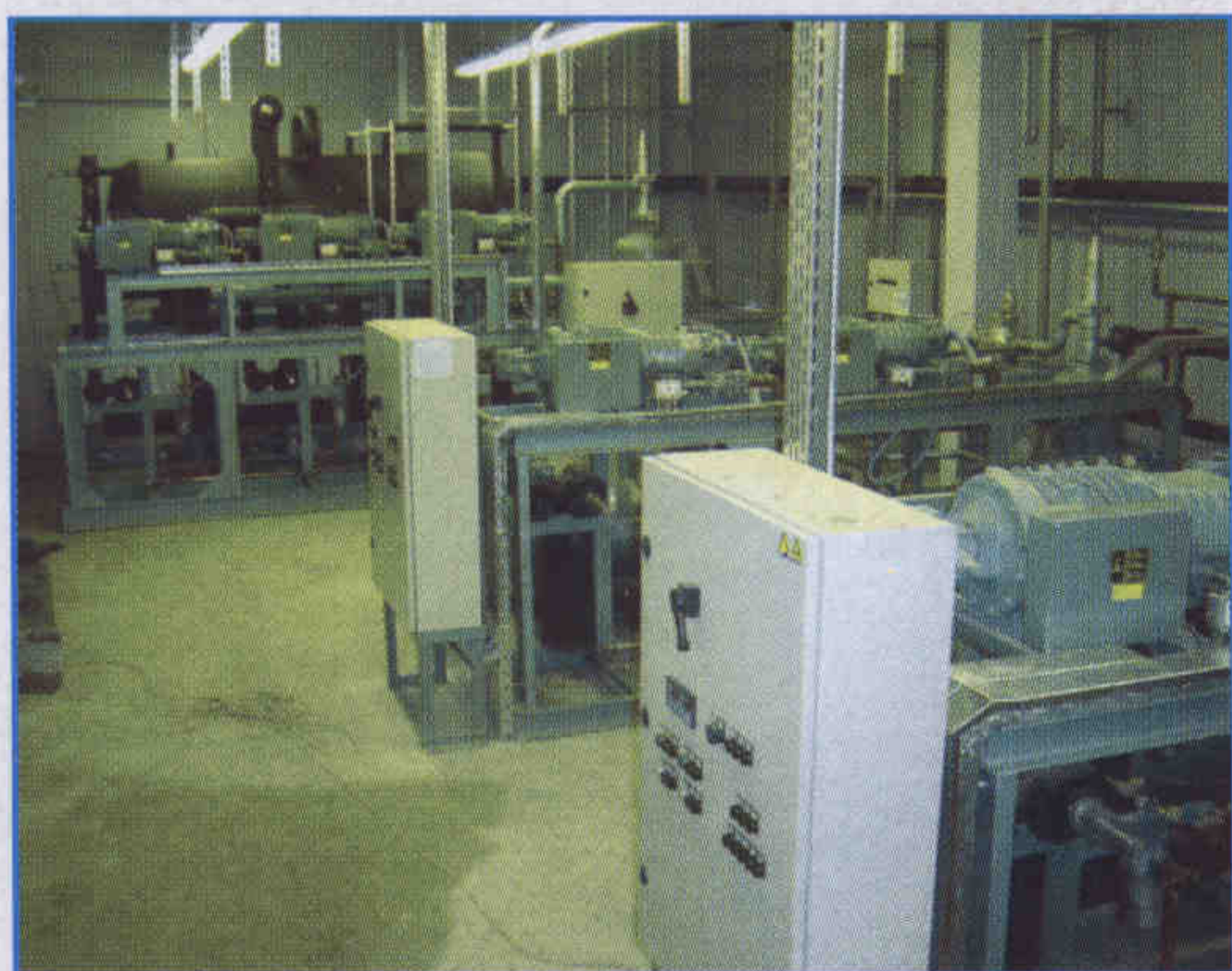
Машинное отделение — компрессорные установки
