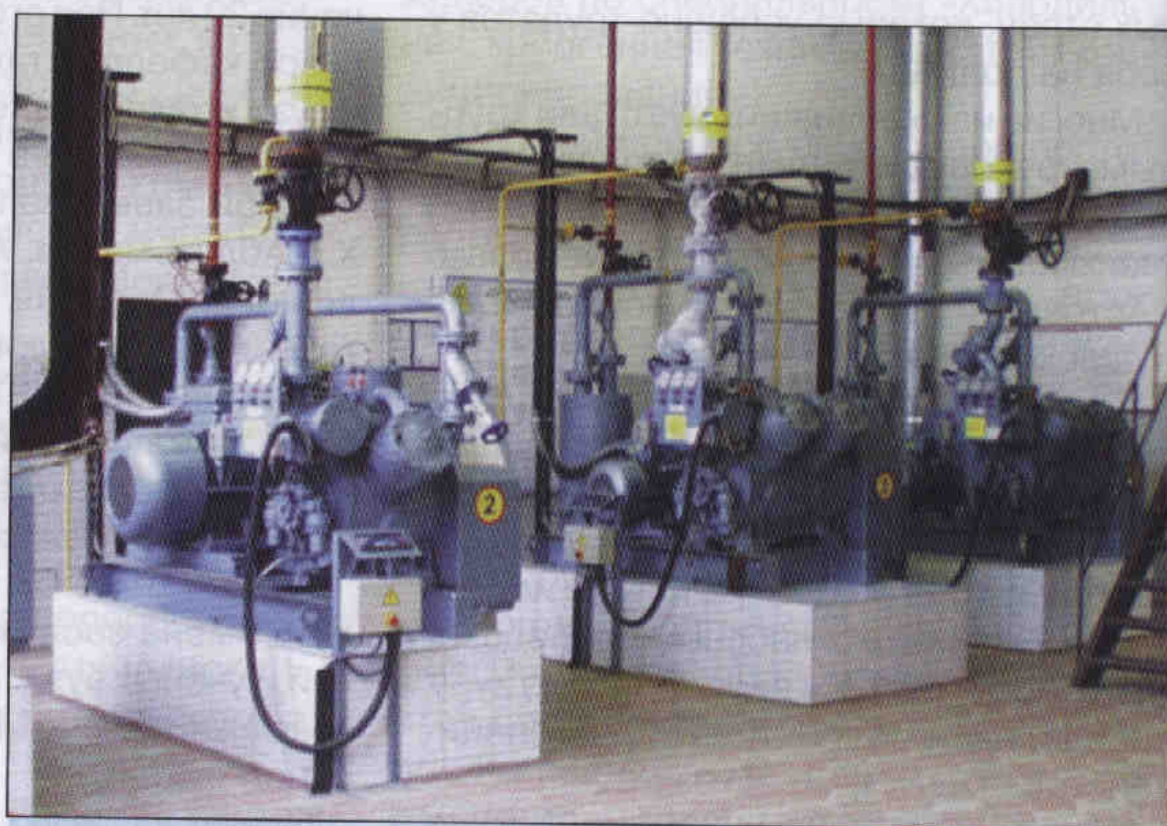
Рис. 2. Размещение компрессорных агрегатов в компрессорном цехе
