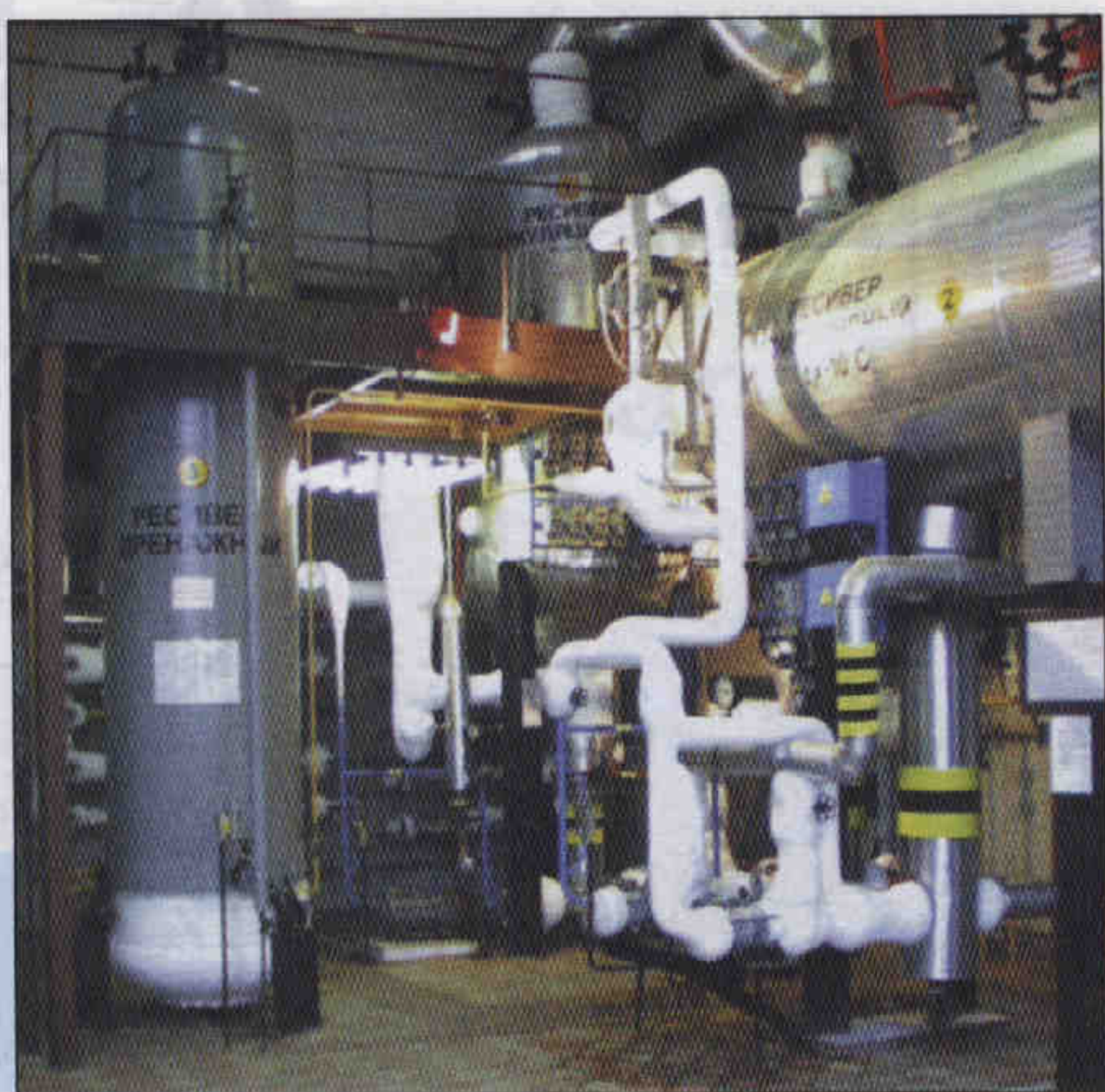
Рис. 3. Размещение в компрессорном цехе ресиверов
