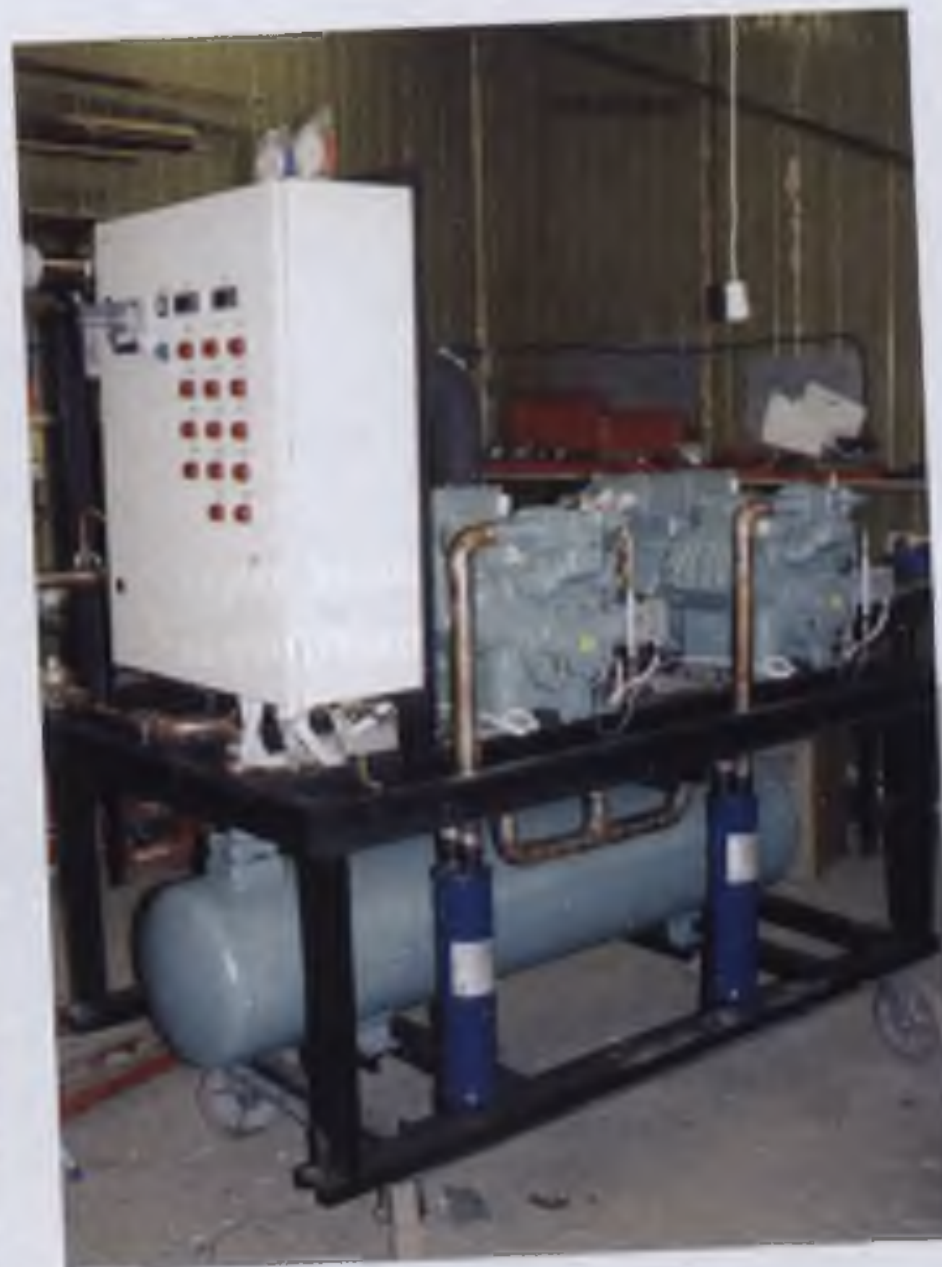
Рис. 2. Центральный блок на базе двух поршневых компрессоров для среднетемпературных камер
