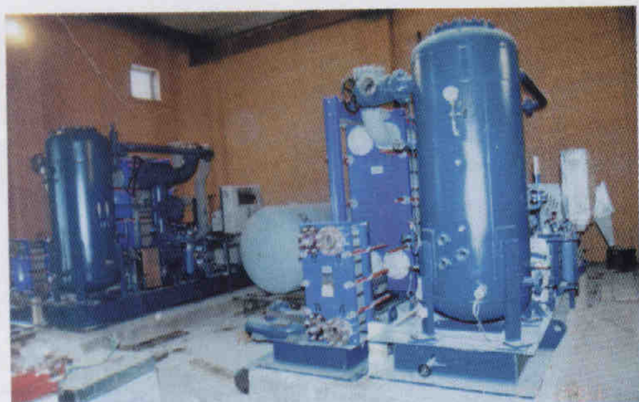
Чиллеры производительностью 2700 кВт для охлаждения раствора \text{CaCl}_2 до температуры t_{32} = -15^\circ\text{C} для катка «Зоркий» (Красногорск). Установленная мощность электродвигателей 500 кВт
