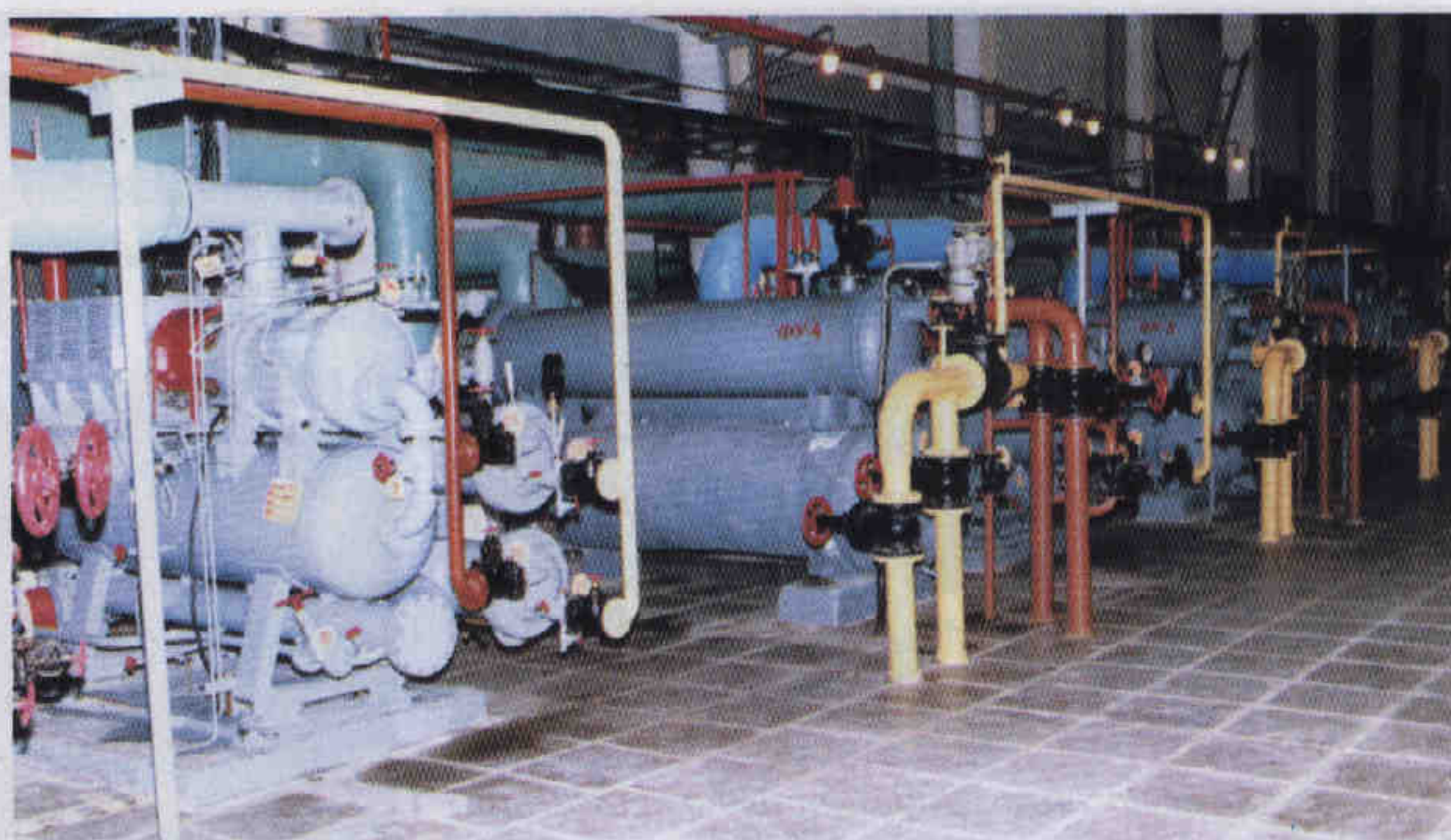
Хладоцентр на одном из горнообогатительных комбинатов, укомплектованный оборудованием НПФ «Химхолодсервис»
