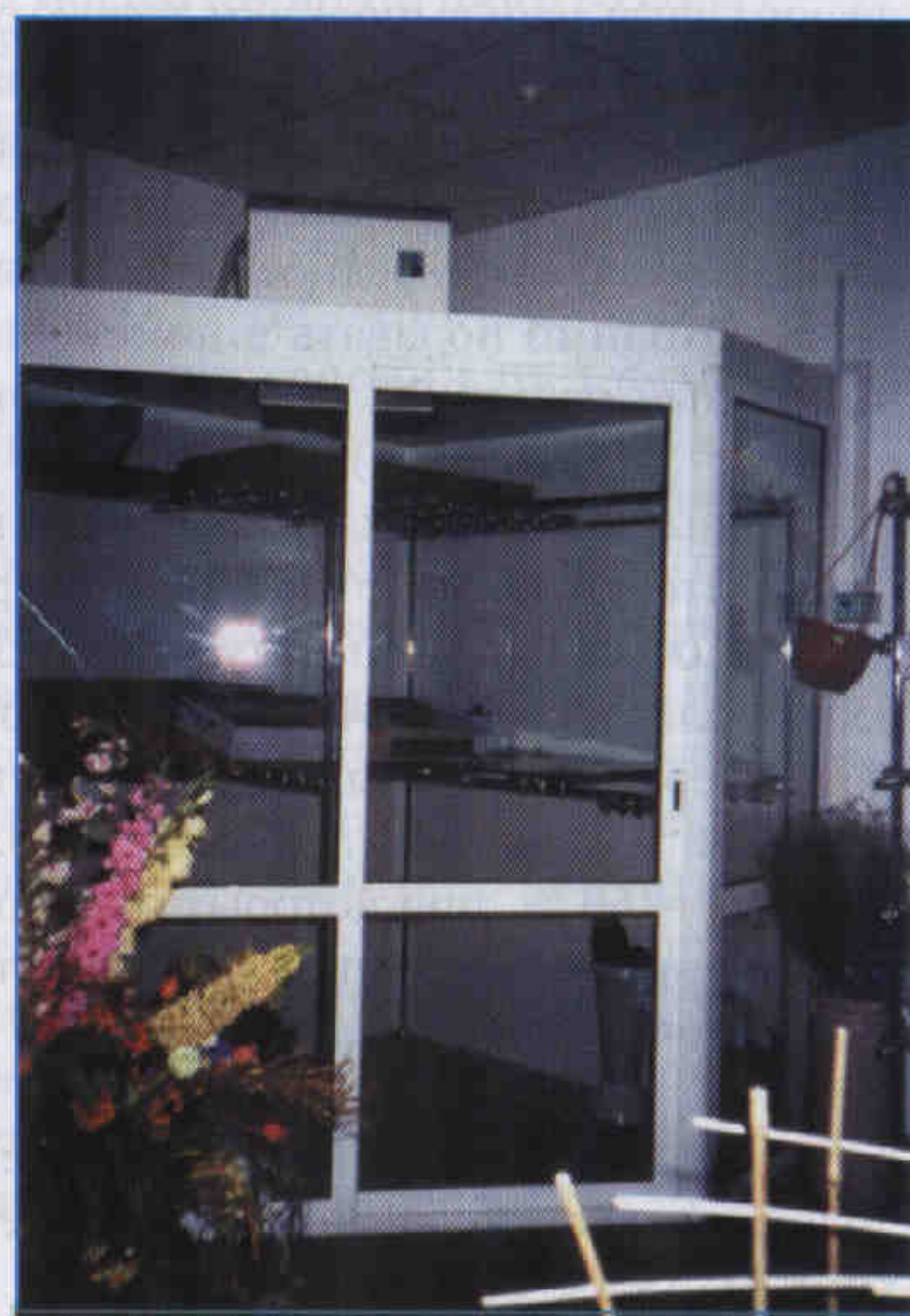
Рис. 2. Моноблок потолочного монтажа SVM075 в камере хранения цветов
