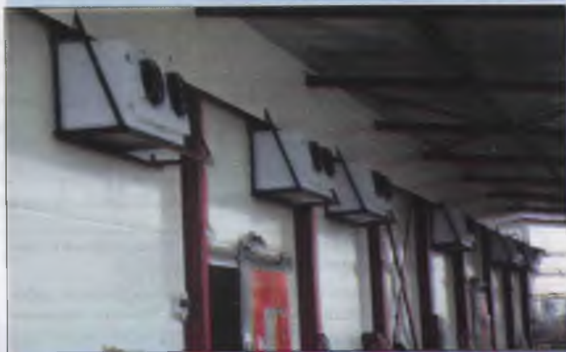
Холодильник вместимостью 1250 т, оборудованный моноблоками серии BRS (г. Калининград)
