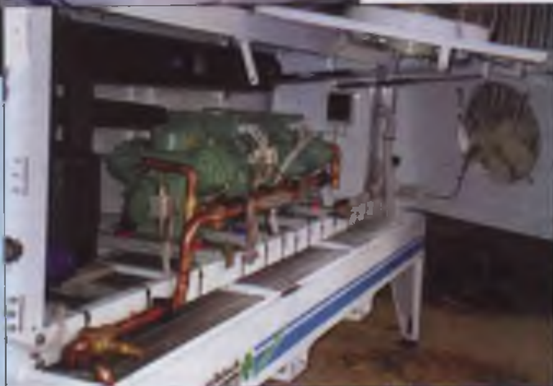
Низкотемпературная камера, переоборудованная из неохлаждаемого склада (Московская обл.). Холодоснабжение осуществляется компрессорно-конденсаторными агрегатами серии HCU с компрессорами Bitzer-тандем
