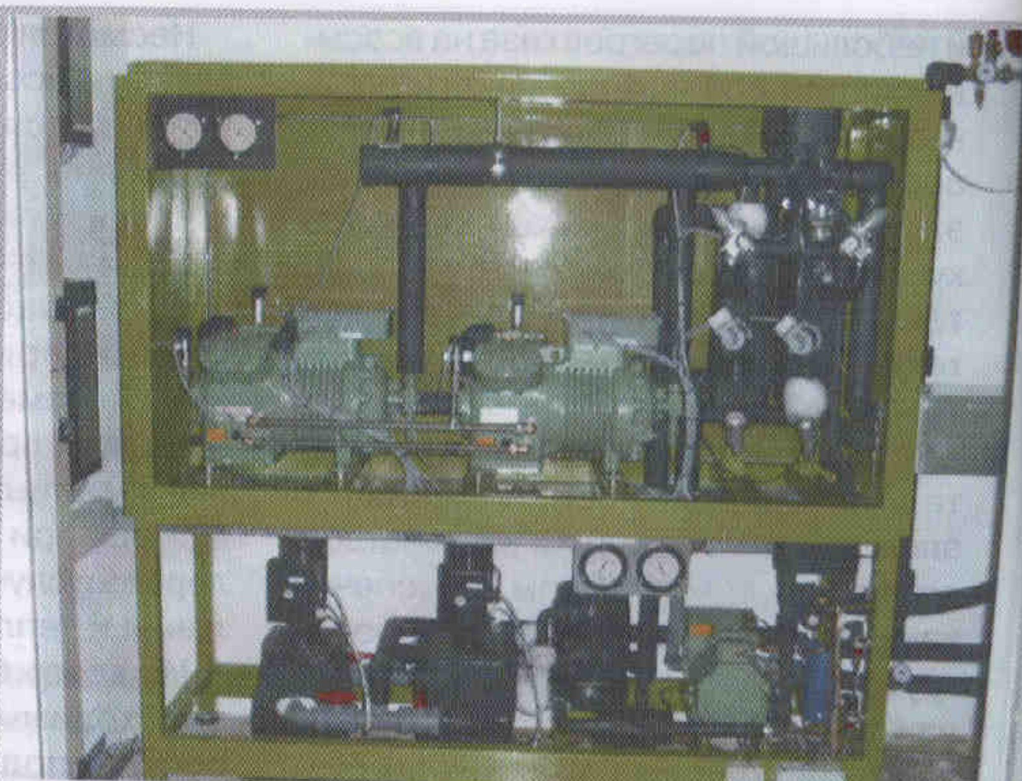
Рис. 13. Каскадная холодильно-морозильная установка с поршневыми компрессорами «Битцер» [верхняя ветвь на R290 (пропан), нижняя – на R744 (CO 2 )]
