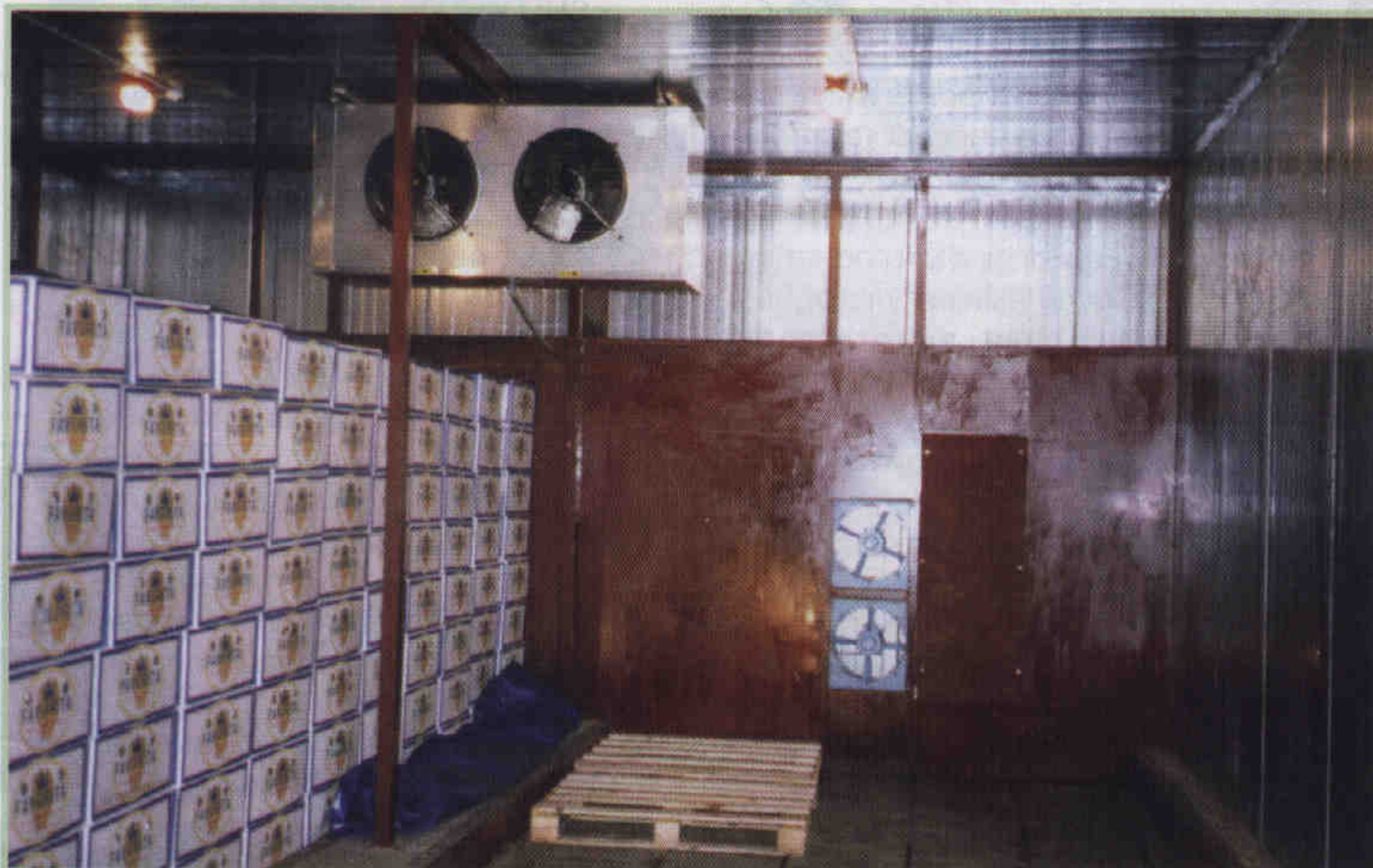
Рис. 1. Камера газации бананов, оснащенная оборудованием фирмы Techpoblock на базе библочного холодильного агрегата IBM-1520 на территории АОЗТ «Новые Черемушки»
